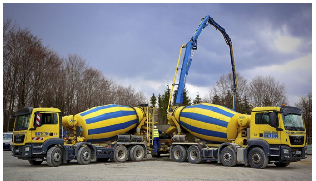
Hier entsteht das Fundament eines Windrads im Windpark Gaugshausen. Zu sehen sind Betonfahrermischer samt Betonpumpe. Jedes der sieben Lieferwerke verfügt über einen eigenen Betonpumpendienst.
